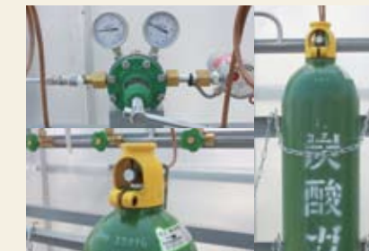
H 炭酸ガス供給システム
