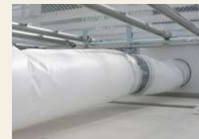
G 冷暖房ヒートポンプ・ベンチ下ダクト
