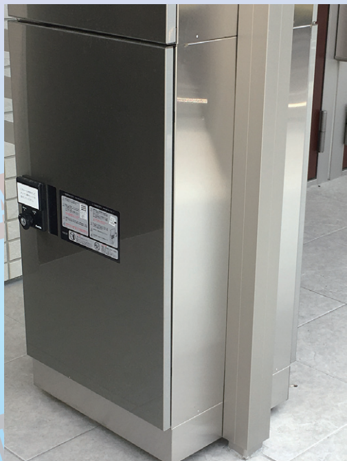
メゾネット型に設置された宅配ボックス
